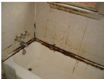
Moho u hongos
