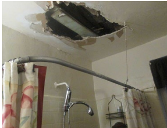
Agujeros en las paredes y el techo
